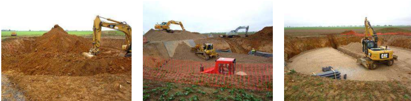
Photo 25 : Exemples de préparation du sol pour la mise en place d'une fondation d'éolienne
