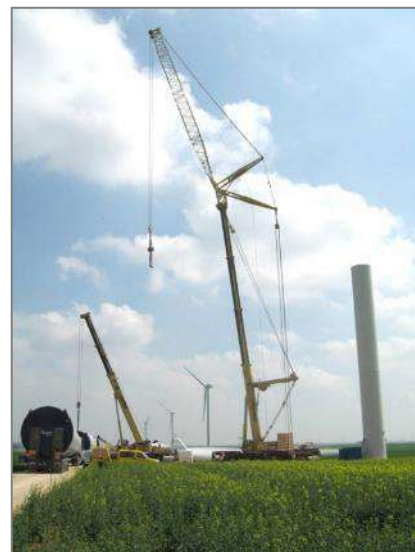
Photo 5 : Montage successif des tronçons de tours. Chantier du parc éolien de Bois Louis (Source : EUROWATT)
