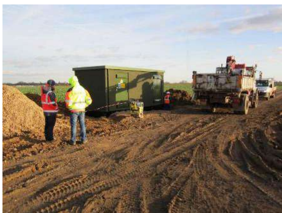
Photo 26 : Exemples d'installation d'un poste de livraison et de passages de camion
